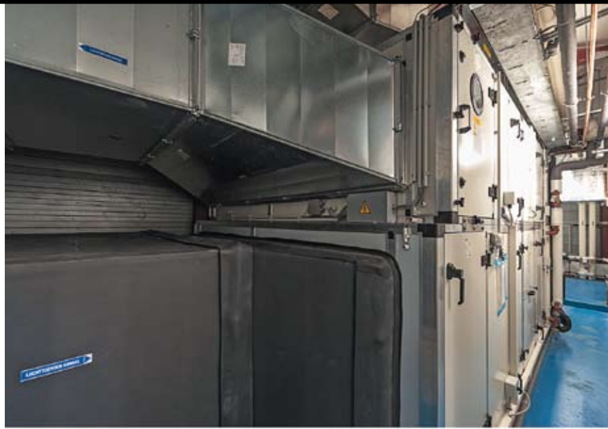
▲ De luchtbehandeling is vernieuwd.
