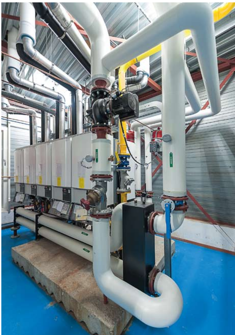
▲ De HR-ketel is hergebruikt, evenals de compressiekoeling.
