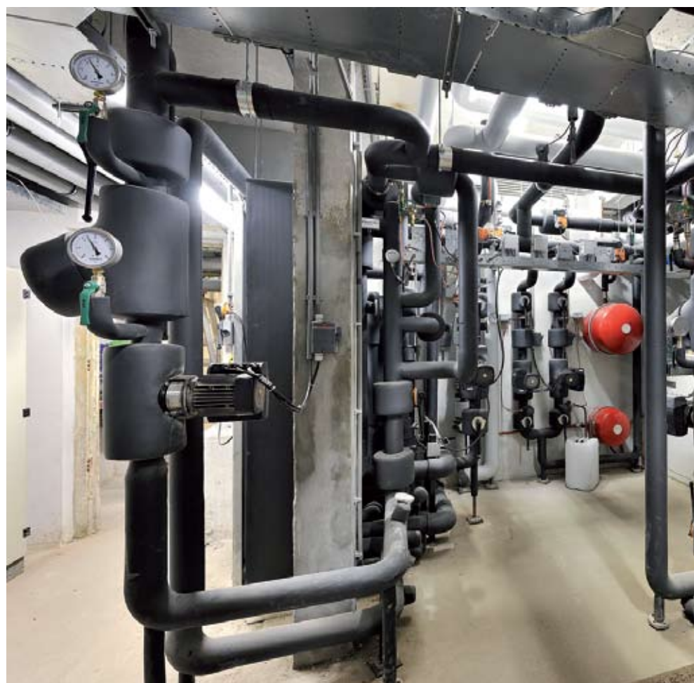
▲ Lage temperatuurverwarming met een WKO installatie en diepe bodemput zorgt voor een energiezuinig en comfortabel gebouw.
